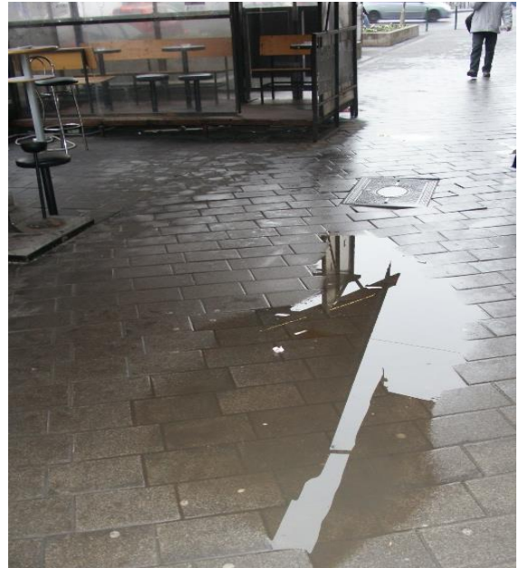
20. ábra: Lokális térkő süllyedés
